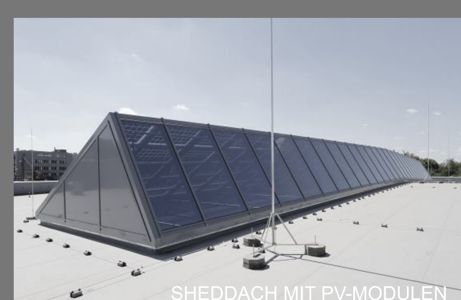
SHEDDACH MIT PV-MODULEN
